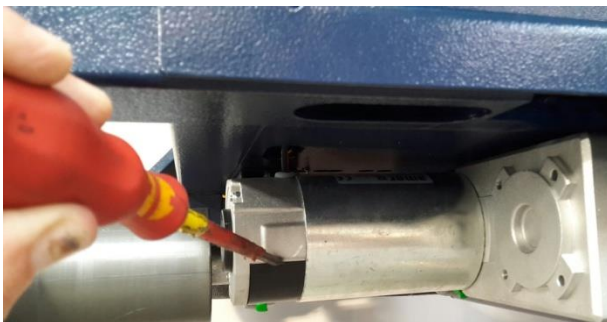
Figuur 5a: Koolborstels inspecteren reinigen
