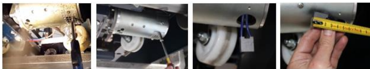
Figura 9.4; Inspección de las escobillas de carbón
