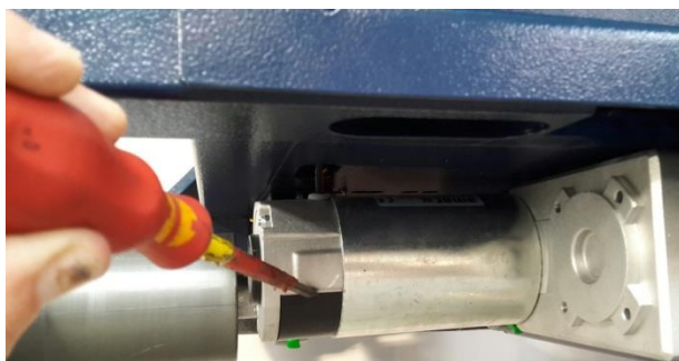
Figuur 5a: Koolborstels inspecteren reinigen
