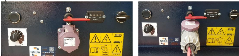
AGV uitschakelen en laadstekker aankoppelen
